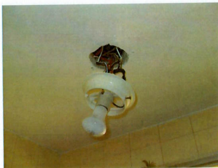
Figura 14 – Contato com partes energizadas
