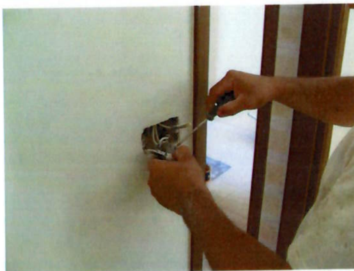
Figura 13 – Exposição a partes elétricas, riscos de choques e queimaduras
