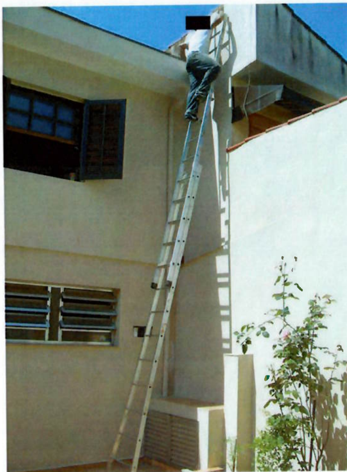
Figura 09 – Trabalho executado em altura sem equipamento de proteção
