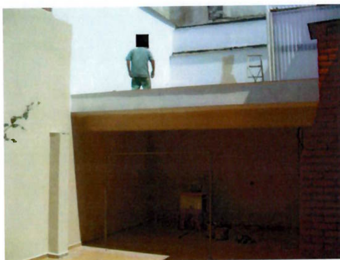
Figura 10 – Trabalho realizado acima de 2m de altura sem o uso de EPI's ou qualquer outra medida de segurança
