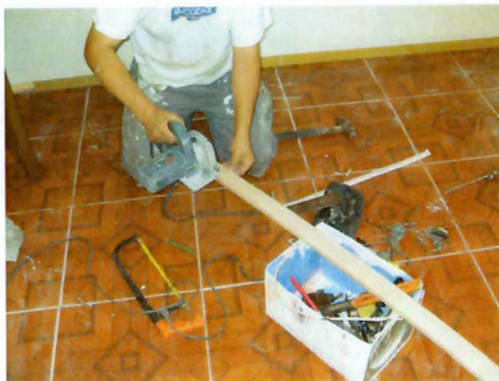
Figura 18 – Ferramentas manuais com risco de corte
